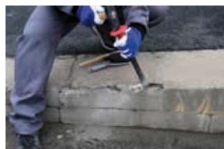
Osekát slabé části narušeného betonu.
